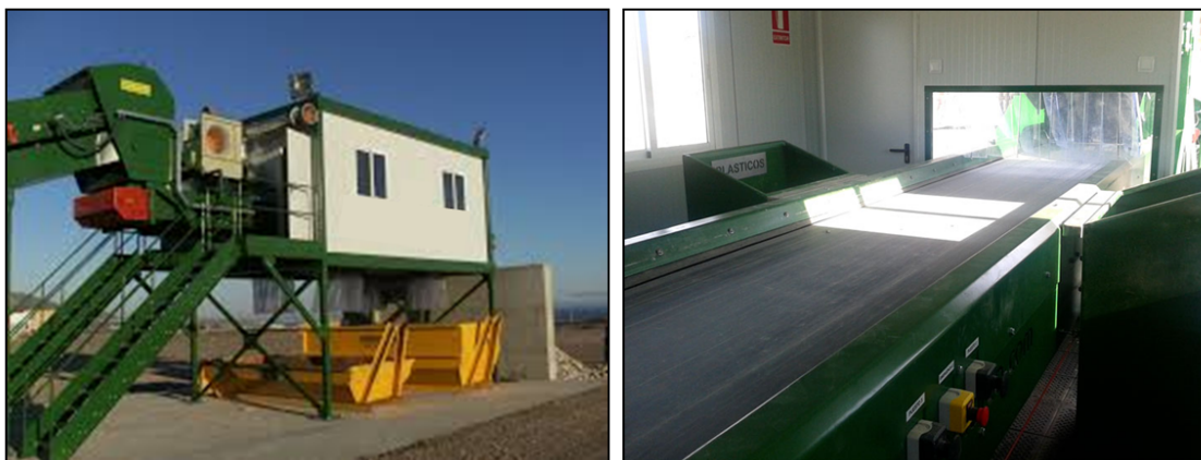
Interior y exterior de cabina de triaje para selección en cinta
