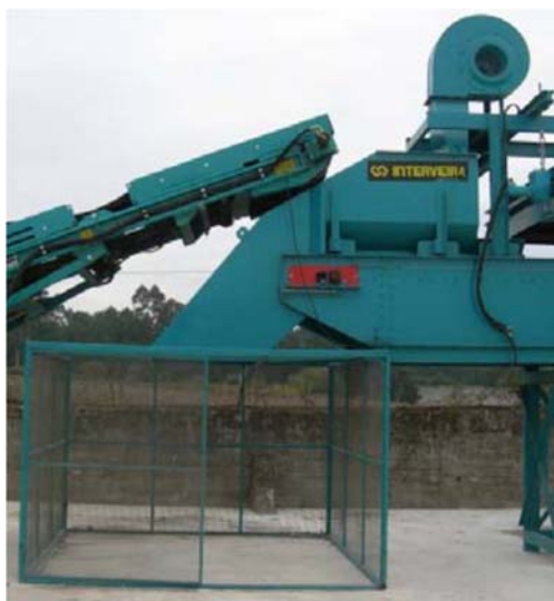
Ventilador para separación de material ligero y jaula de almacenamiento
